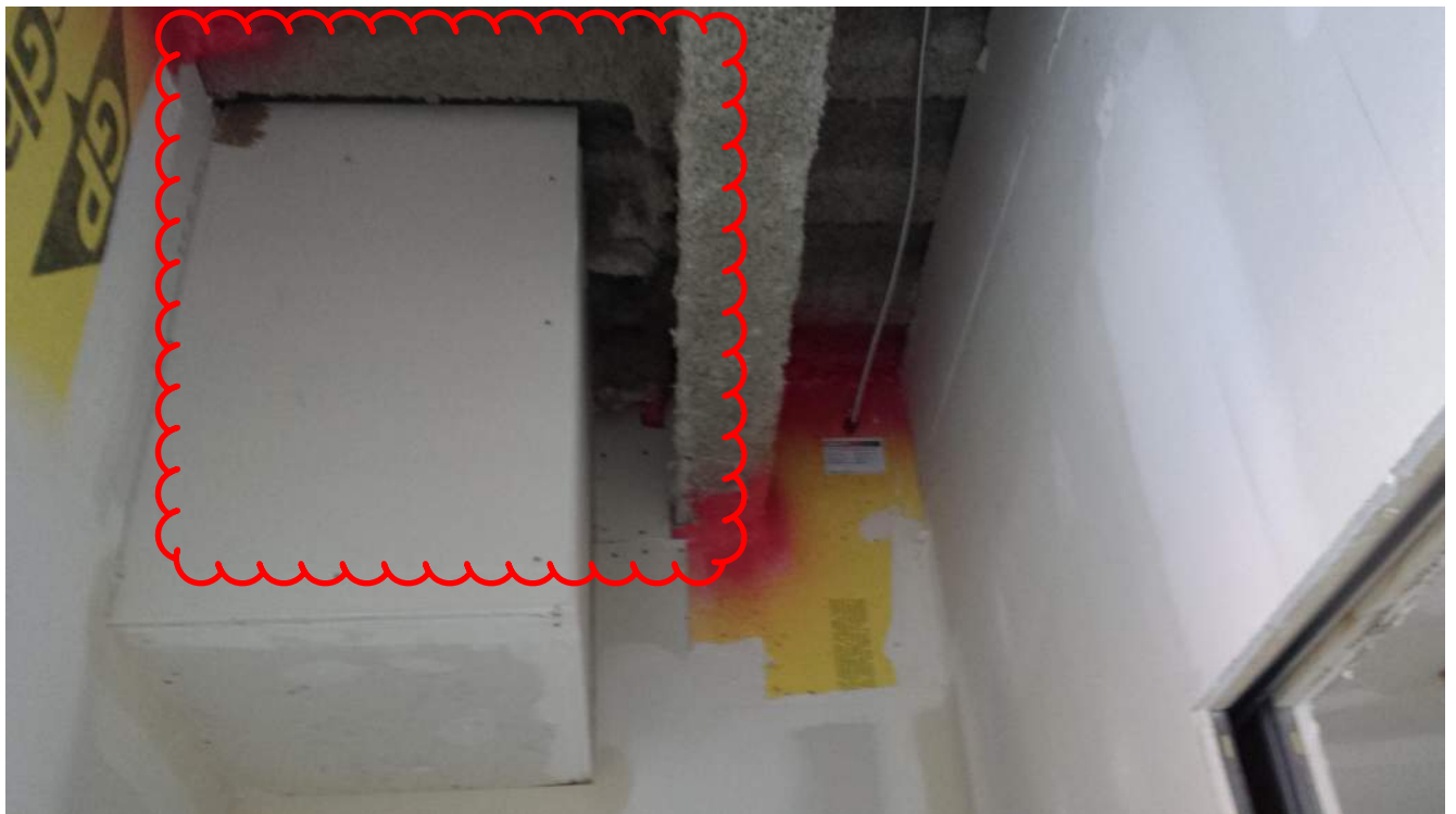
See note 23.06. Break room 1005 shown
