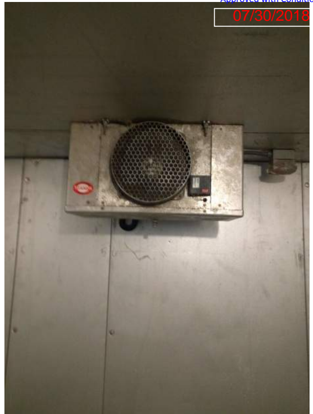
Cooling Unit Fan
