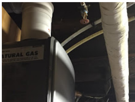
sprinkler head over Rinai #1.jpg 31K
