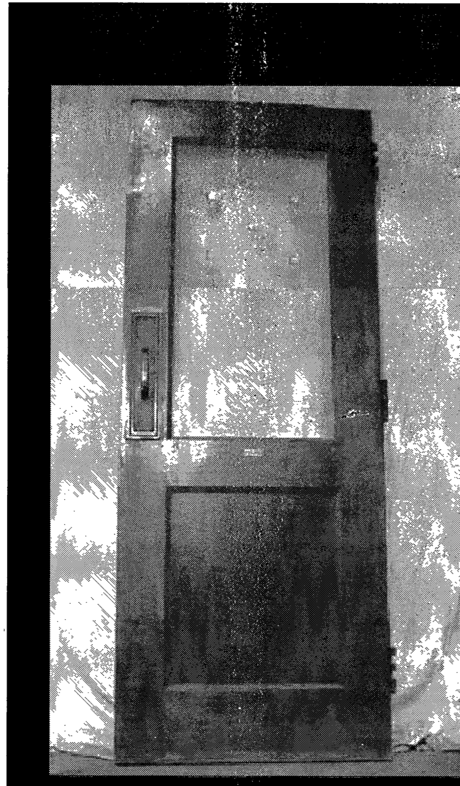
FR DOOR # 20 DOOR THICKNESS 1-3/8" DOOR WIDTH 30" DOOR HEIGHT 79-3/4"
