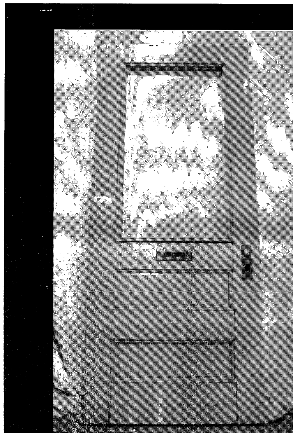
FR DOOR # 16 DOOR THICKNESS 1-3/4" DOOR WIDTH 31" DOOR HEIGHT 80-3/8"
