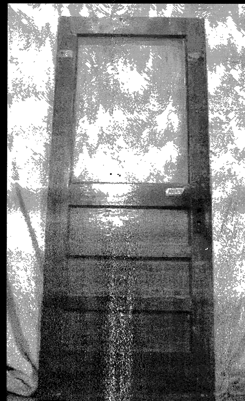
FR DOOR # 15 DOOR THICKNESS 1-3/4" DOOR WIDTH 32" DOOR HEIGHT 82-3/4"
